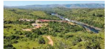
Futura planta de tratamiento de aguas residuales de Capari / Angola
