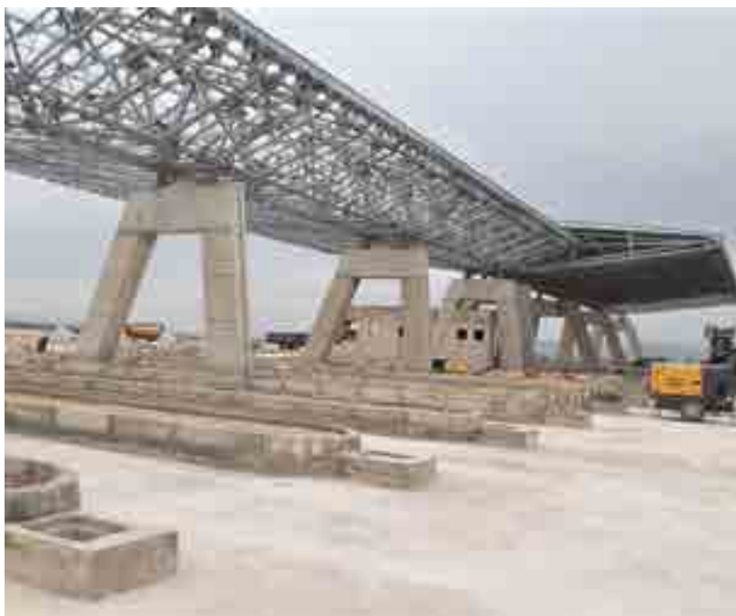
Installations et équipements d'exploitation de l'autoroute Est - Ouest / Lot Ouest
